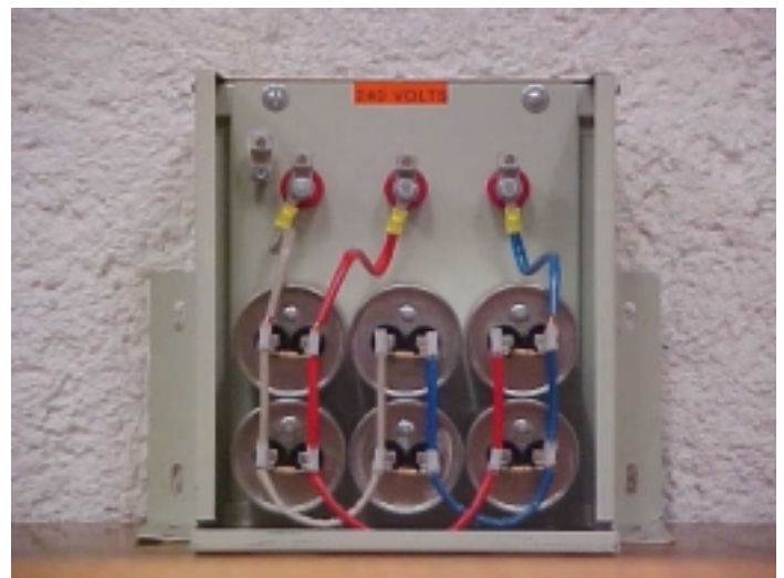
Arreglo de celdas capacitivas en banco fijo
